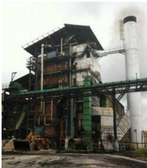
Figura 3 - Caldeira em funcionamento
