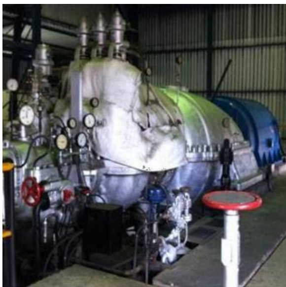
Figura 6 - Gerador de Condensação em funcionamento
