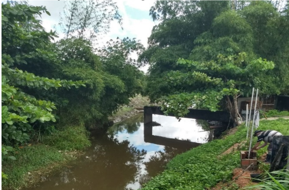
Figura 11: Construção de muro nas margens do rio para funcionamento de pocilga.
