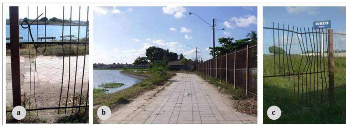
Figura 51: (a, b, c) Gradis degradados no entorno da lagoa.
