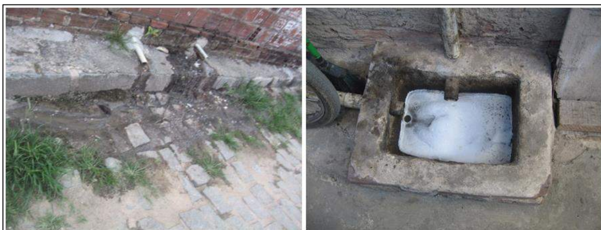
Figura 47: Soluções improvisadas de esgoto
