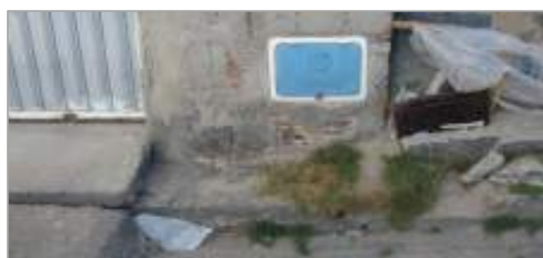
Figura 49: Abastecimento formal de água
