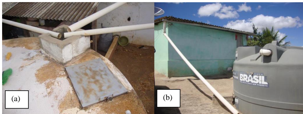
Figura 22 – Caixa de desvio (a); (b) Cano desconectado
