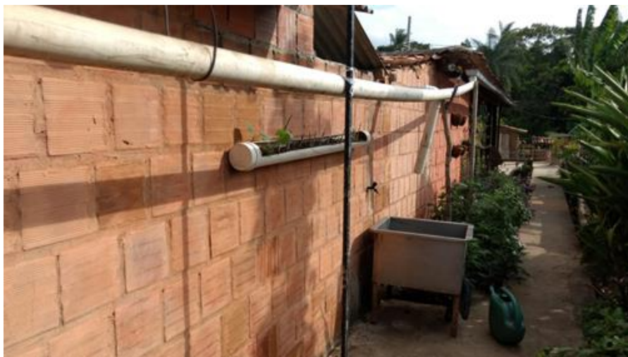
Figura 32 - Sistema de captação de água da chuva no Restaurante da comunidade Chã de Jardim
