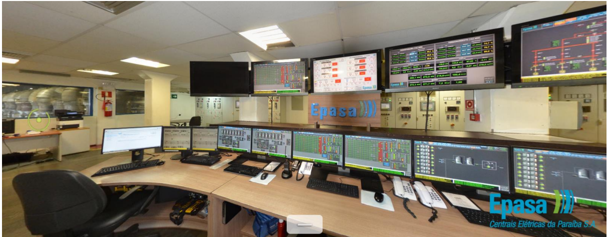
Figura 9 – Sala de Controlos Usina Termonordeste
