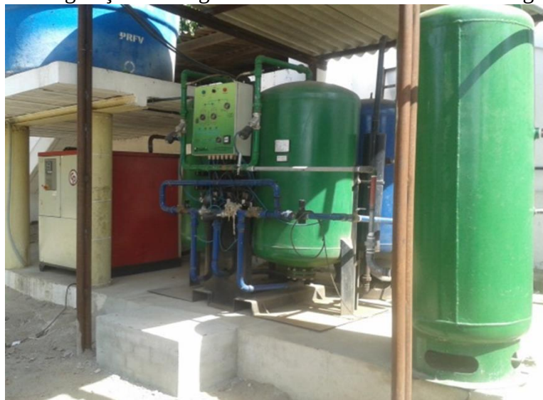
Figura 2.7 - Sistema de geração e dosagem de ozônio da Usina Monte Alegre
