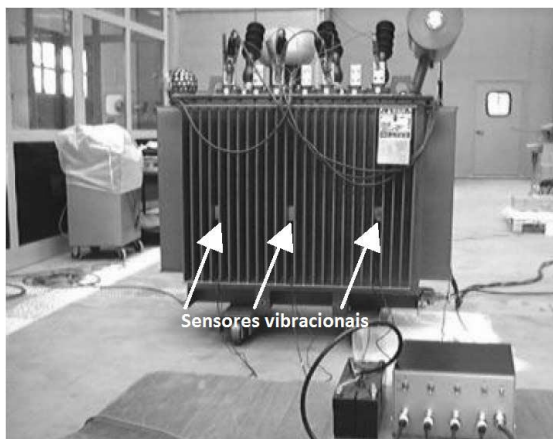
FIGURA 4 - SENSORES DE VIBRAÇÃO FIXADOS AO TRANSFORMADOR, ADAPTADO DE [11].
