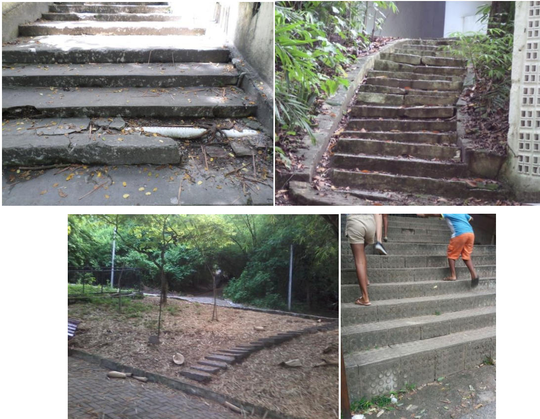
Figura 44: Fotos mostrando a situação de algumas escadarias encontradas no Parque Zoobotânico Arruda Câmara.
