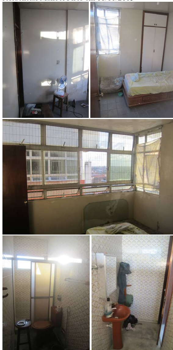
Figura 95: Fotos da DCE da cobertura do edifício residencial Manoel Pires em 08/10/2015
