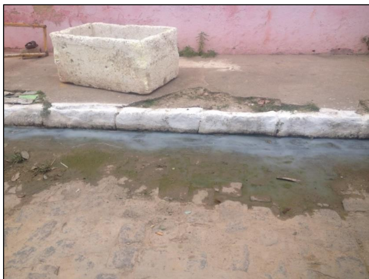
Figura 29 – Lançamento de esgoto em via pública da cidade de Pitimbu.
