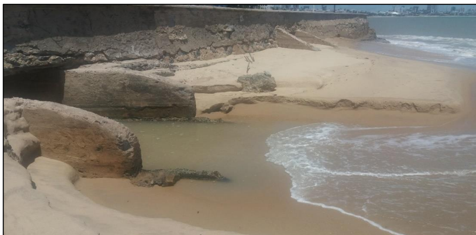
Figura 2 – Galeria pluvial com ocorrências, frequentes, de despejo clandestino de esgoto na Praia de Manaíra, João Pessoa.
