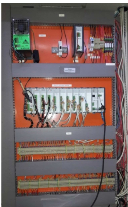
Figura 3.13 – Painel com CLP instalado.
