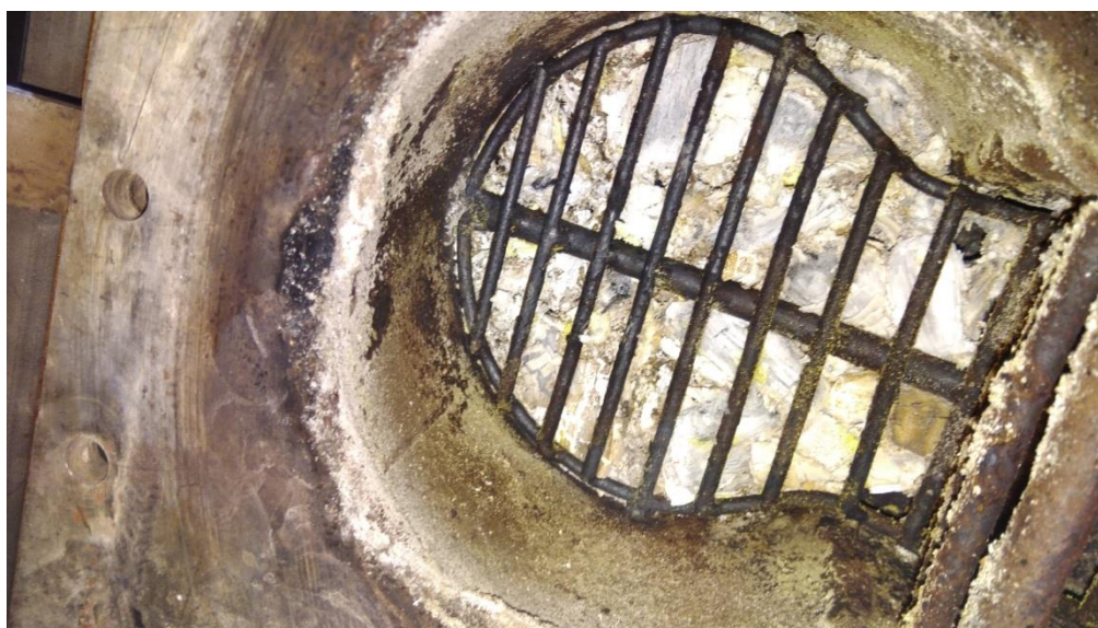
Figura 3. Acúmulo de cinzas acima da grelha (Autor).
