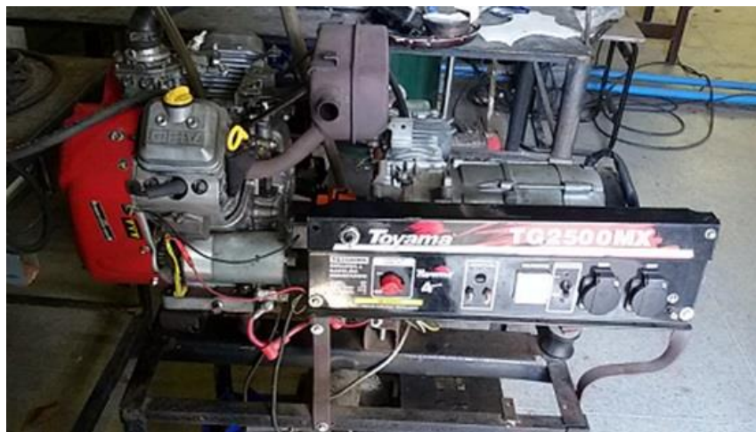
Figura 6. Motor acoplado ao gerador.
