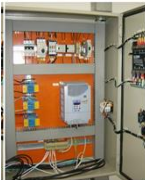
Figura 13 - Foto do painel com inversor de frequência.
