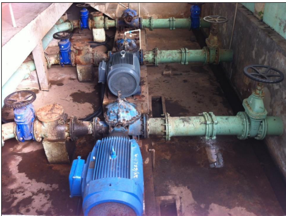
Figura 17 – Disposição em paralelo da Elevatória Mario Andreazza
