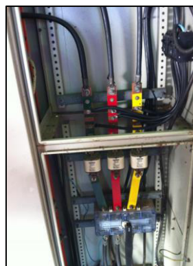
b) Alimentação elétrica dos motores (interior do gabinete)
