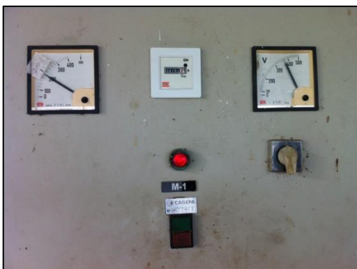
a) Gabinete de leituras elétricas e acionamento de motores
