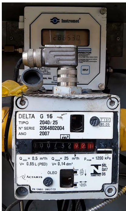
Figura 4.3 – Medidor de vazão de gás.
