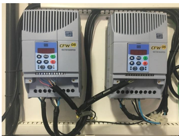
Figura 5.4 Inversores de frequência utilizados para acionar os sistemas de impulsão.
