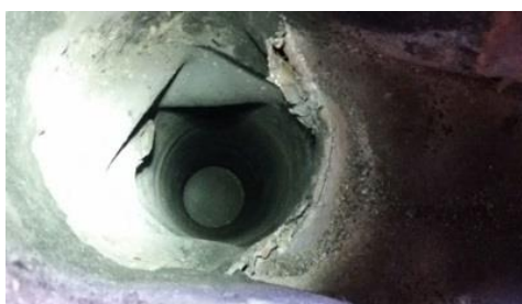
Figura 3-3: Aspecto da deformação plástica no interior do reator.
