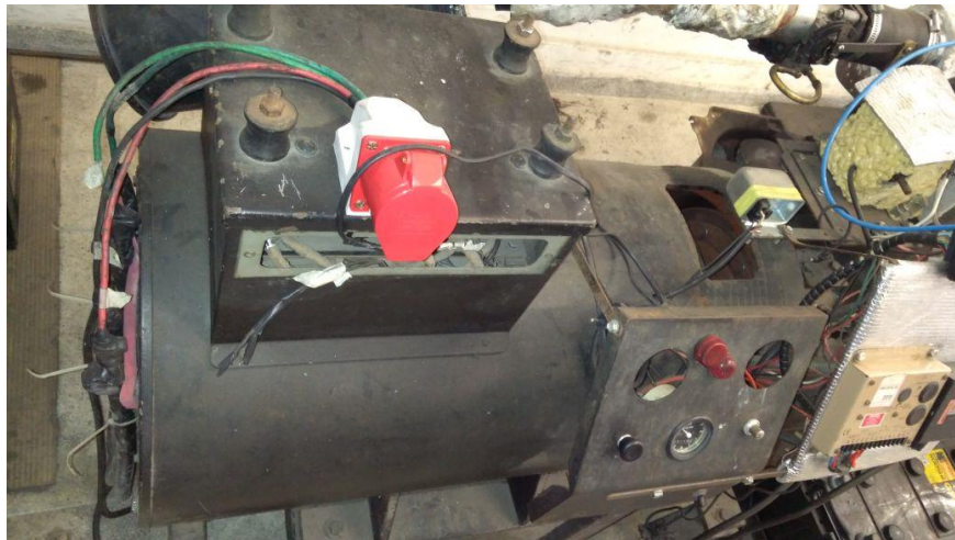
Figura 15: Gerador de Energia Elétrica
