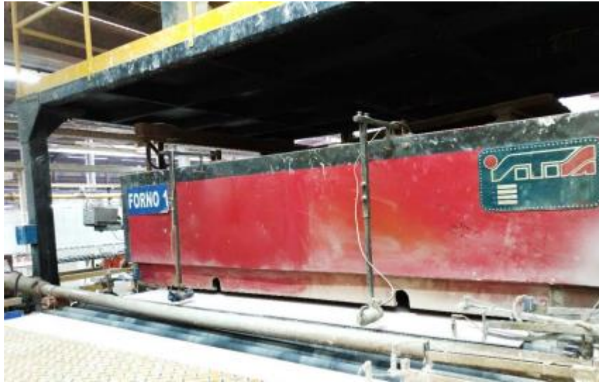
Figura 13 – Forno horizontal contínuo.
