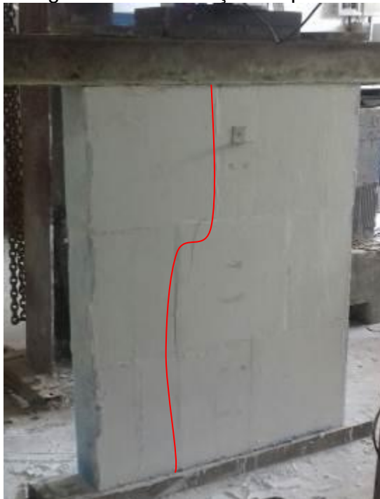
Figura 53 - Fissuração da parede
