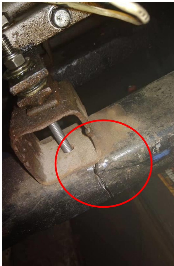
Figura 15 - Vista frontal da viga rompida.
