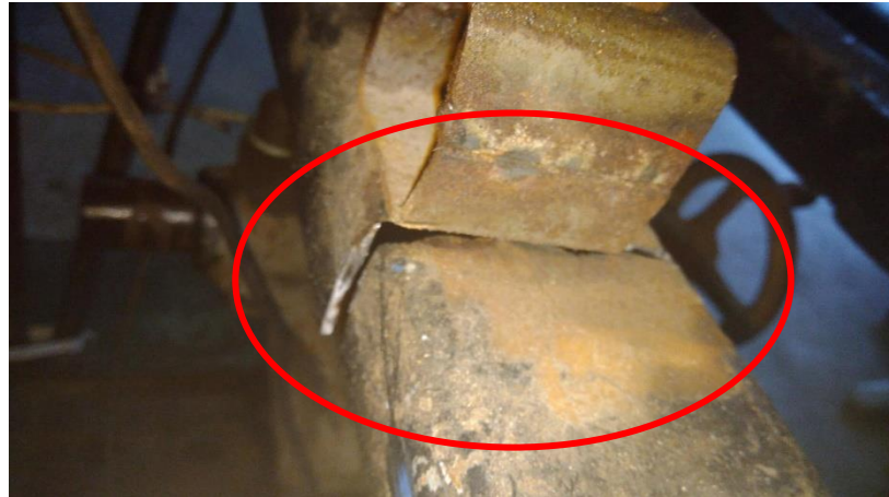
Figura 16 - Vista lateral da viga rompida.
