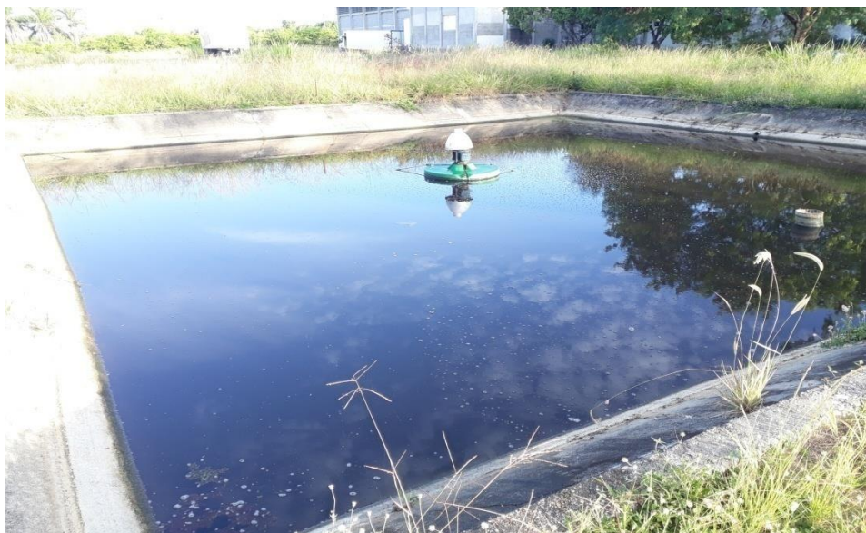
Figura 8 - Tanque de equalização.
