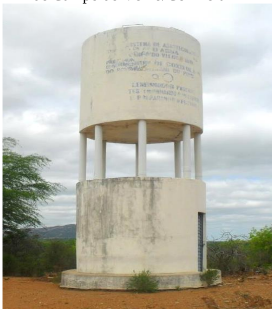
Fotografia 06 – Caixa d'água da comunidade de Campo do Velho/Coxixola-PB
