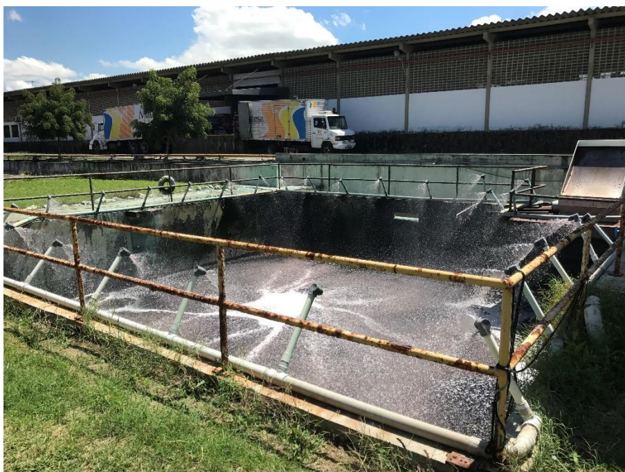
Figura 3 - Tanque primário do ETE da indústria têxtil estudada
