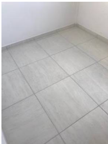
Figura 19 - Piso original de cerâmica no quarto onde foi realizado o ensaio em campo – POCamp.
