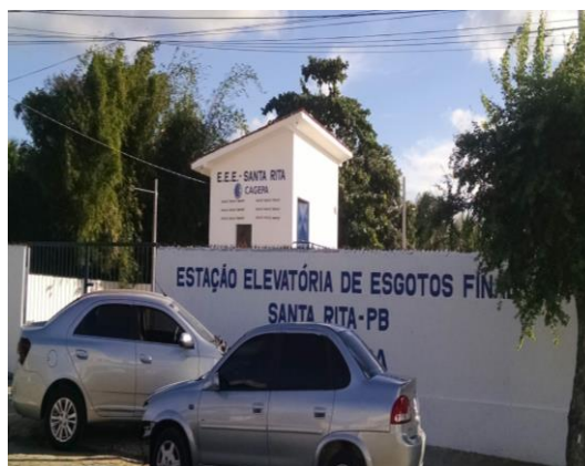
Figura 11. Estação elevatória da CAGEPA, próximo ao Ponto 2 (P2) no mês de abril de 2017, na Av. Anísio Pereira Borges, centro da cidade de Santa Rita-PB. Fonte: Acervo da autora.
