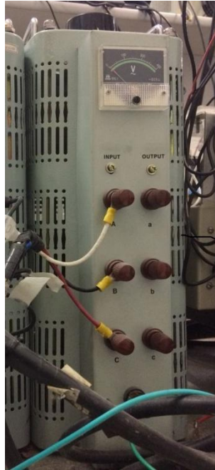
Figura 57 – Variador de tensão trifásico. Fonte: autora
