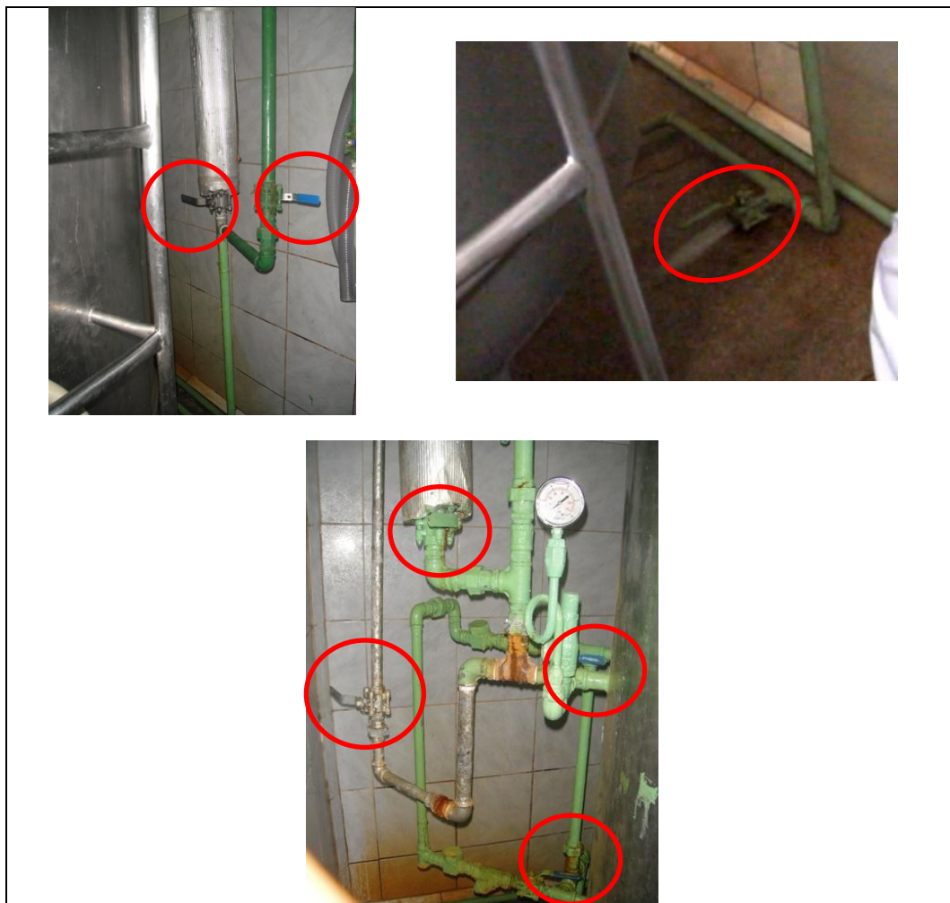
Figura 26 – Válvulas acionadas no preparo da coalhada
