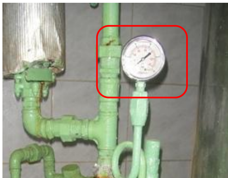
Figura 28 – Manômetro da tubulação de vapor de água quente
