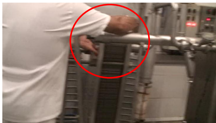
Figura 16 – O operador verifica a temperatura da tubulação com o tato (5°C)
