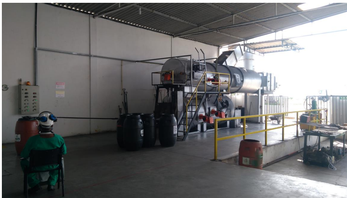
Figura 18 – Instalações de tratamento de RSS na empresa B. Fonte: Autora (2018).
