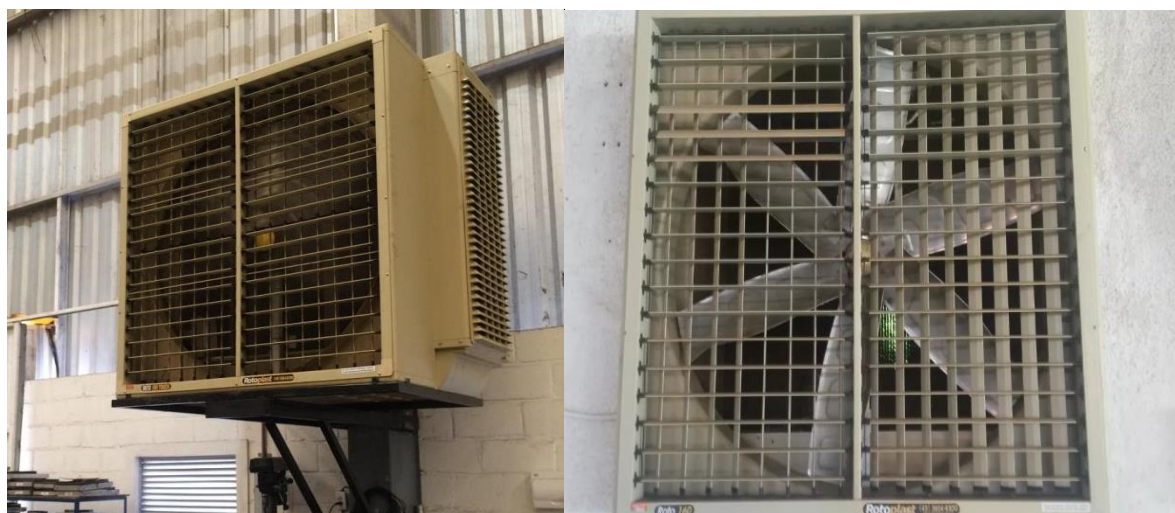
Figura 22: Climatizador e exaustor instalados na oficina de manutenção industrial.
