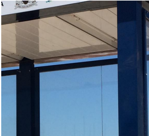
Figura 14: Revestimento em PVC e iluminação tubular
