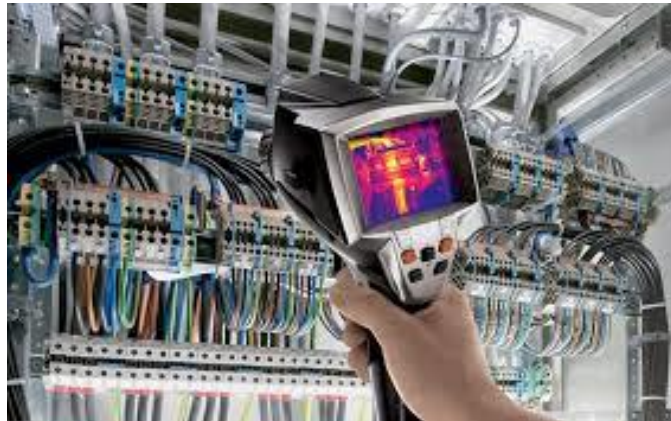
Figura 5 - Manutenção preditiva em circuito de energia elétrica.
