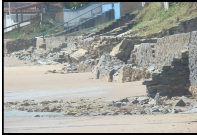
Figura 44. Muretas de contenção destruídas.
