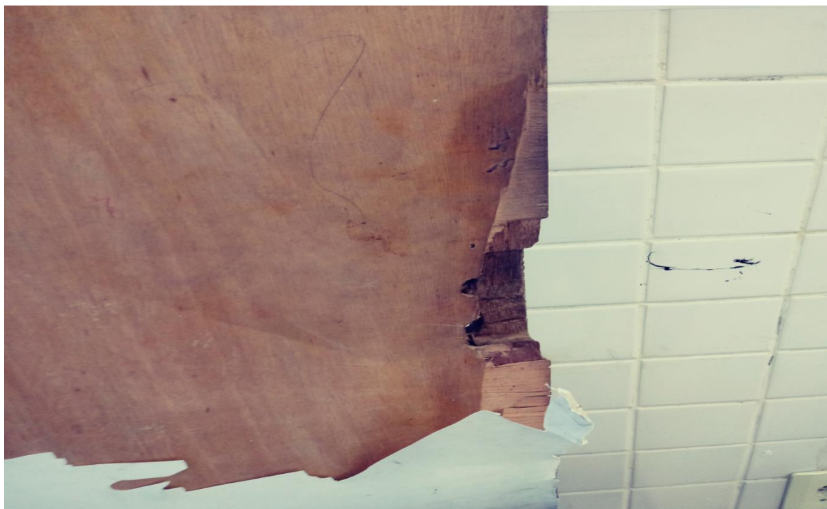
Foto 04 - Porta de uma das salas de aula da escola. Nesta ocorrência, a fechadura da porta também foi danificada.
