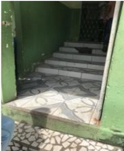
Degraus dificultam o acesso à escola - Não observância a acessibilidade.
