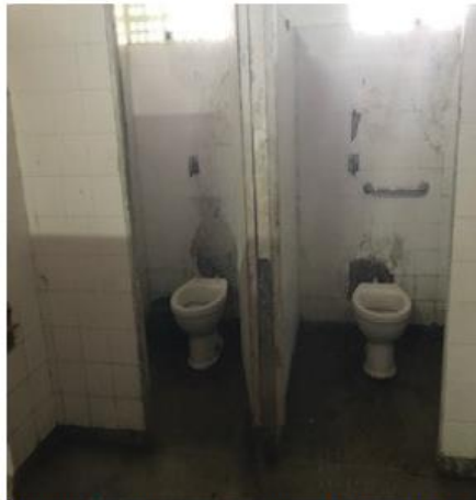
Banheiros sem portas e em péssimos estado de conservação e manutenção.
