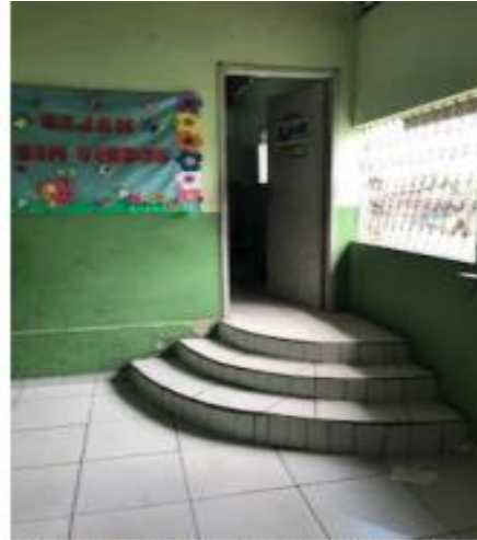
Degraus dificultam o acesso às salas de aula
