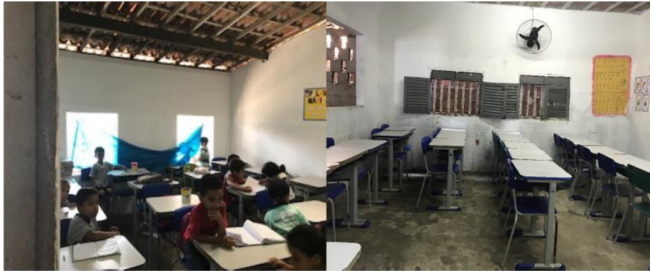
IMAGEM 22- Sala de aula em condições precárias
