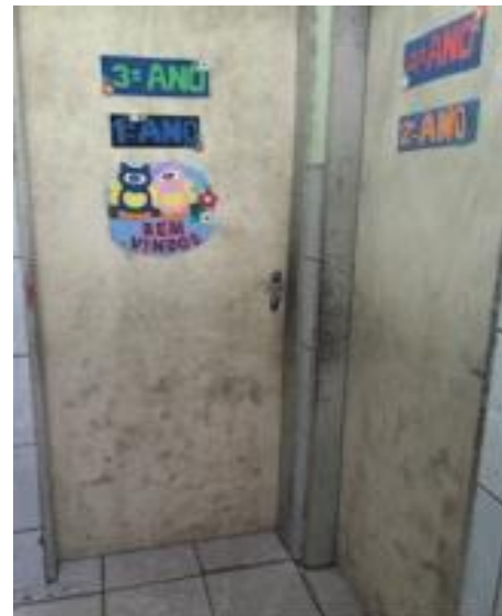
Falta de manutenção
