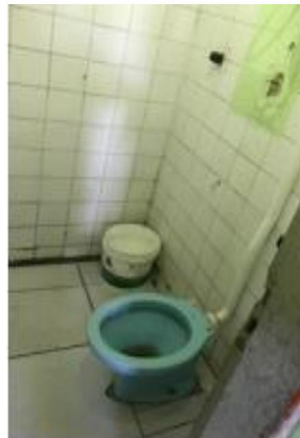
Banheiros com instalações precárias
