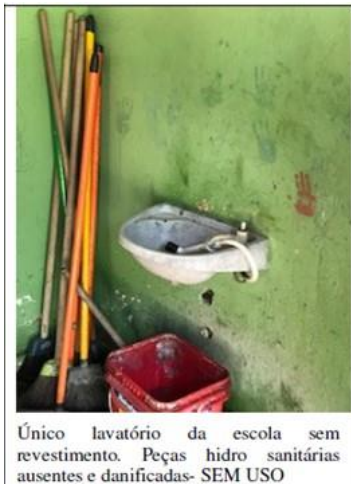
IMAGEM 23- Pia sem manutenção
