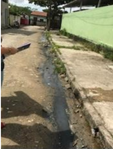
Esgoto a céu aberto
