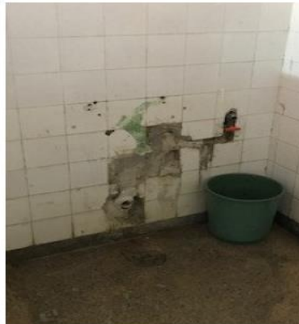
Banheiros sem lavatórios e com revestimento de parede danificado.
