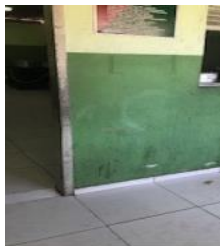
Cozinha sem despensa para armazenar mantimentos e ausência de refeitório
