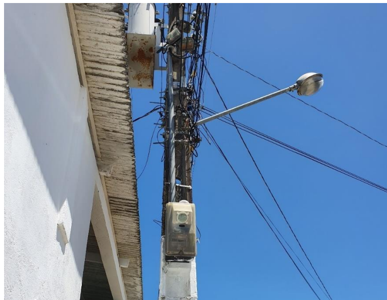
Figura 3 - Padrão externo com Caixas Padrão Rede (CPrede).
