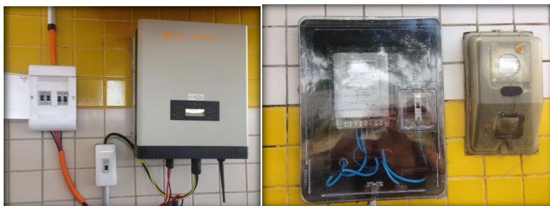
Figura 39 – Proteção, Inversor e Medidores da Energisa.
