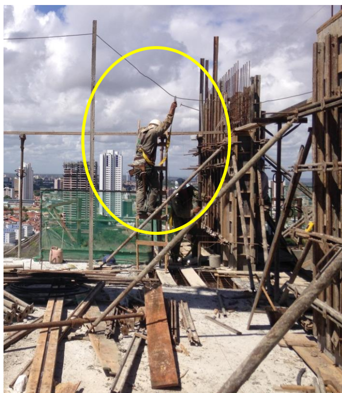
Figura 50 - Trabalhador utilizando cinto preso à linha de vida
