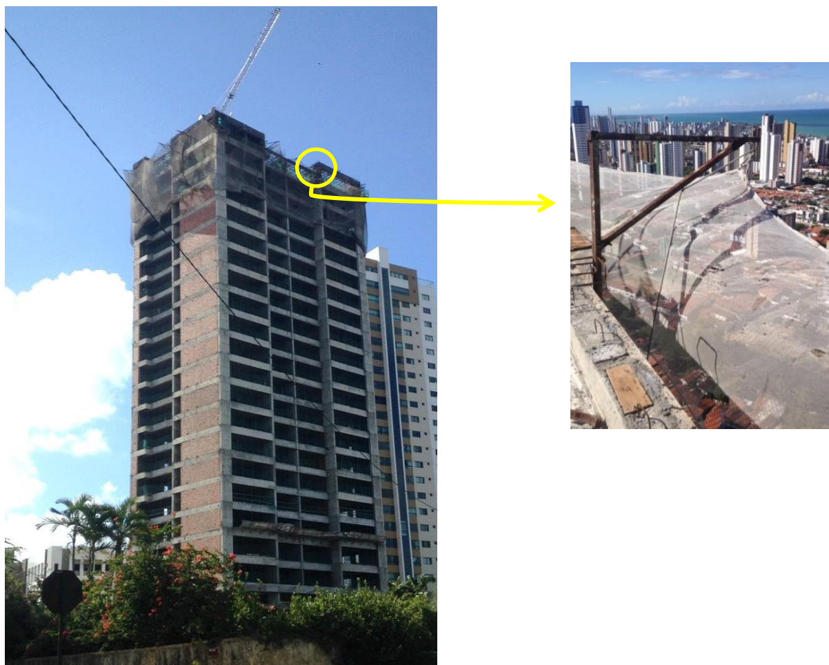
Figura 51 - Rede de proteção com detalhe de fixação na estrutura
