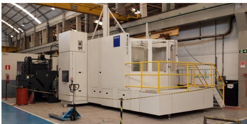
Figura 1.1.a Fundação de máquinas. Fonte: Concretizar (2017)
