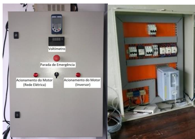
Figura 4.2- Quadro de comando. Fonte: Autor.
