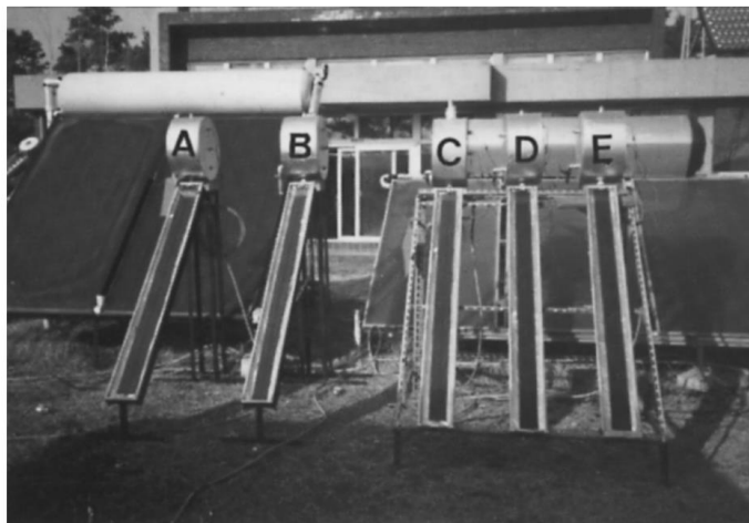
Figura 5 - Mini sistemas para captação da radiação solar
