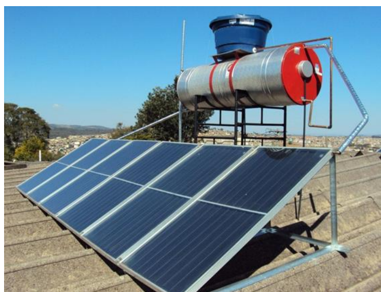
Figura 17 - Sistema de aquecimento de água por coletor solar de placas planas.
