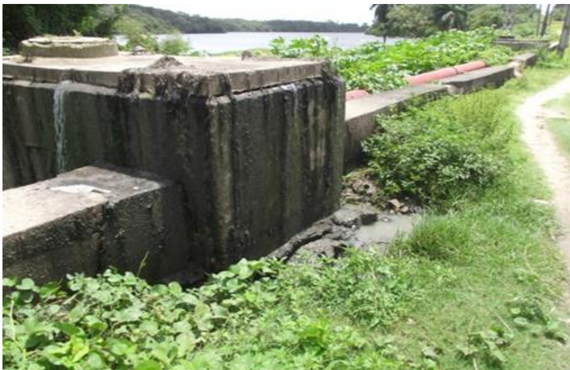
Figura 6 - Rede de coletora as margens do reservatório com transbordo de efluente
