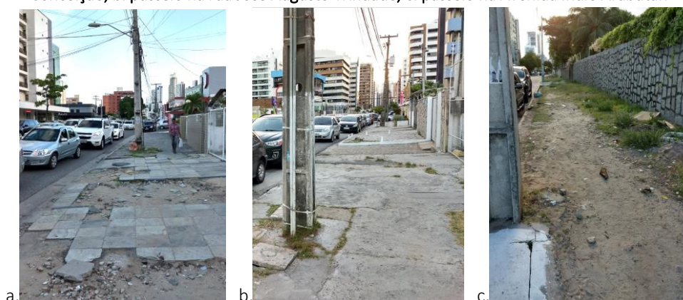
Figura 108 – Condições mais comuns dos passeios públicos no buffer estudado. a. passeio na Avenida Marcioníla da Conceição; b. passeio na rua José Augusto Trindade; c. passeio na Avenida Índio Arbutan
