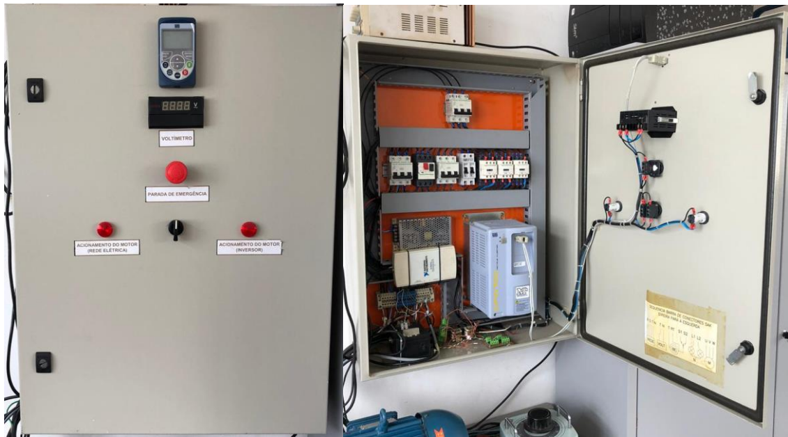
Figura 3.11 - Quadro de comando.
