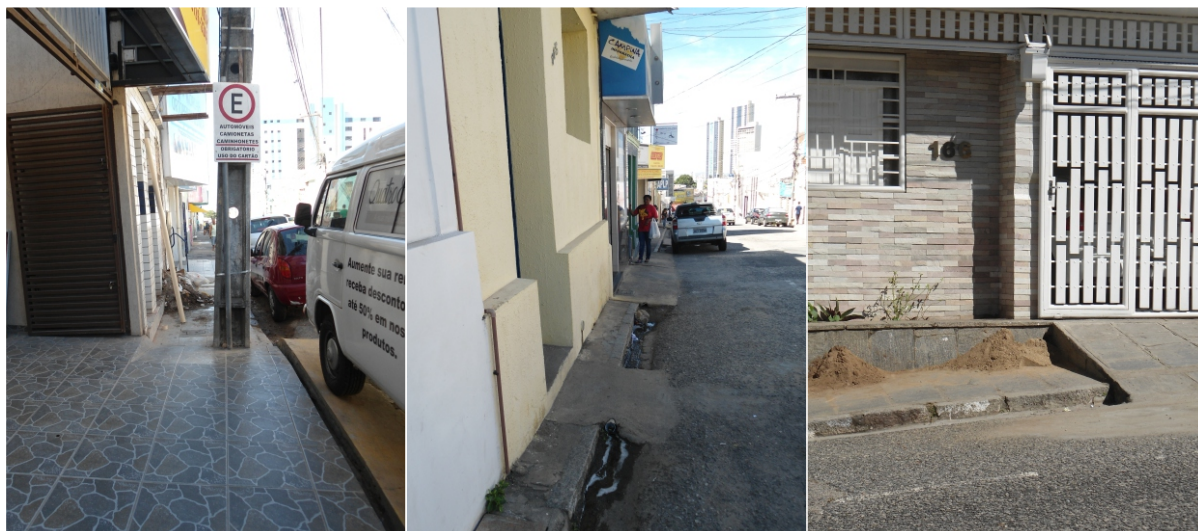
Figura 4.17: Problemas encontrados na rua Juvino do Ó.
