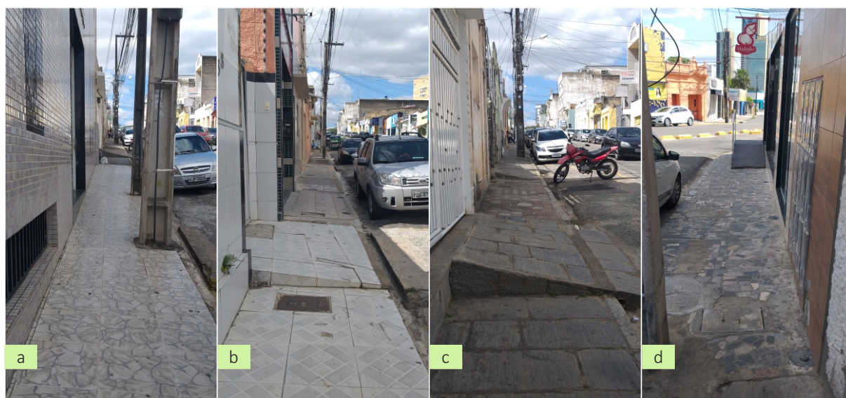
Figura 4.18: Problemas encontrados no trecho 19a.
