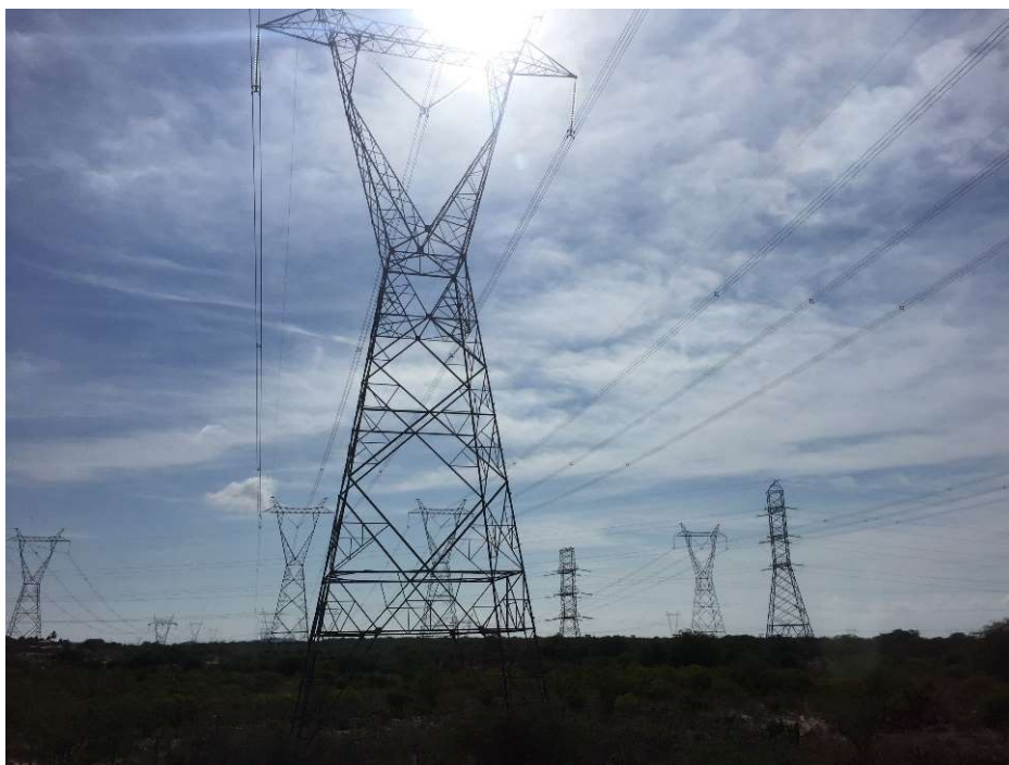
FIGURA 3 - LINHAS DE TRANSMISSÃO DE ENERGIA ELÉTRICA NA CIDADE DE PAULO AFONSO – BA.
