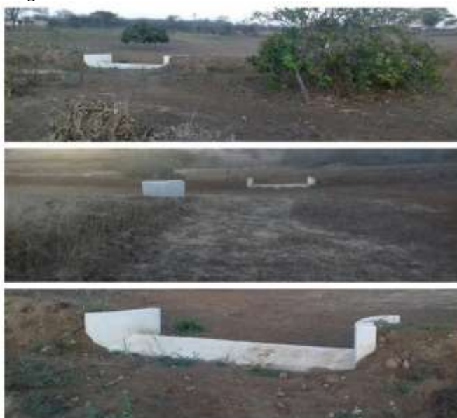
Figura 8 -Barragem subterrânea na Comunidade Rural de Malhada de Areia
