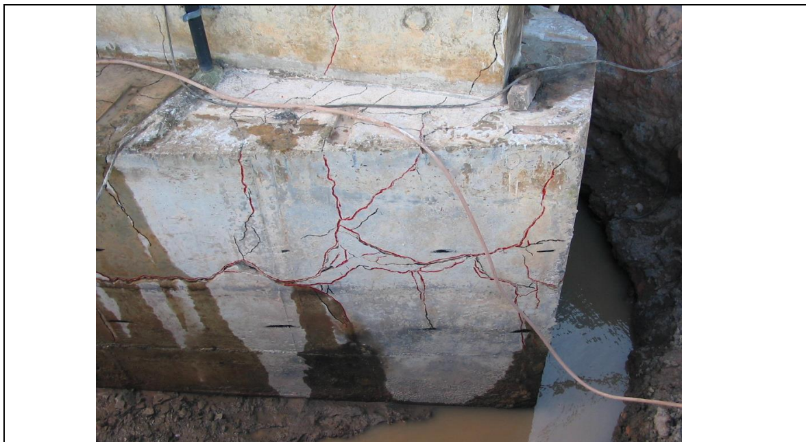
Figura 2.6. Fissuras nas faces laterais de um bloco. Fonte: Autor
