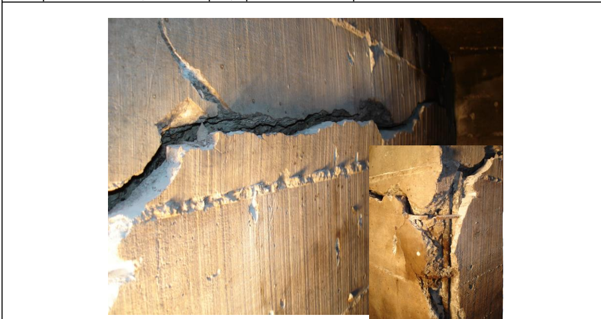
Figura 2.5. Detalhe de uma trinca na superfície lateral de um bloco, com ruptura de uma costela (armadura horizontal) no encontro de duas superfícies laterais. Fonte: Autor
