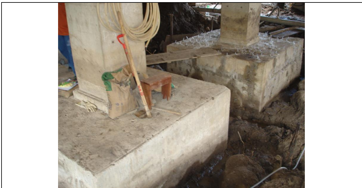
Figura 2.3. Visão de 2 blocos, sendo que o da direita, com concreto fornecido pela concreteira B está intensamente fissurado, já preparado para injeção de epóxi, enquanto o bloco da esquerda, executado com o concreto da concreteira A sem apresentar nenhuma fissura. Fonte: Autor
