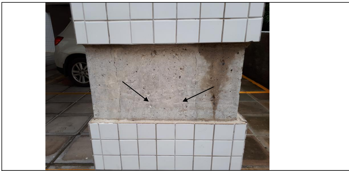
Figura 2.7. Pilar de um edifício residencial de 16 pavimentos fissurado pela RAA. Fonte: Autor
