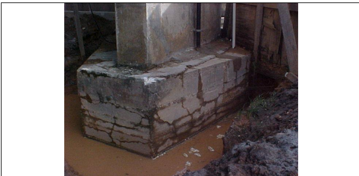
Figura 2.4. Visão geral de um bloco de fundação do edifício público, onde pode ser observado as superfícies laterais, recém limpas, apresentando um quadro fissuratório. Fonte: Autor
