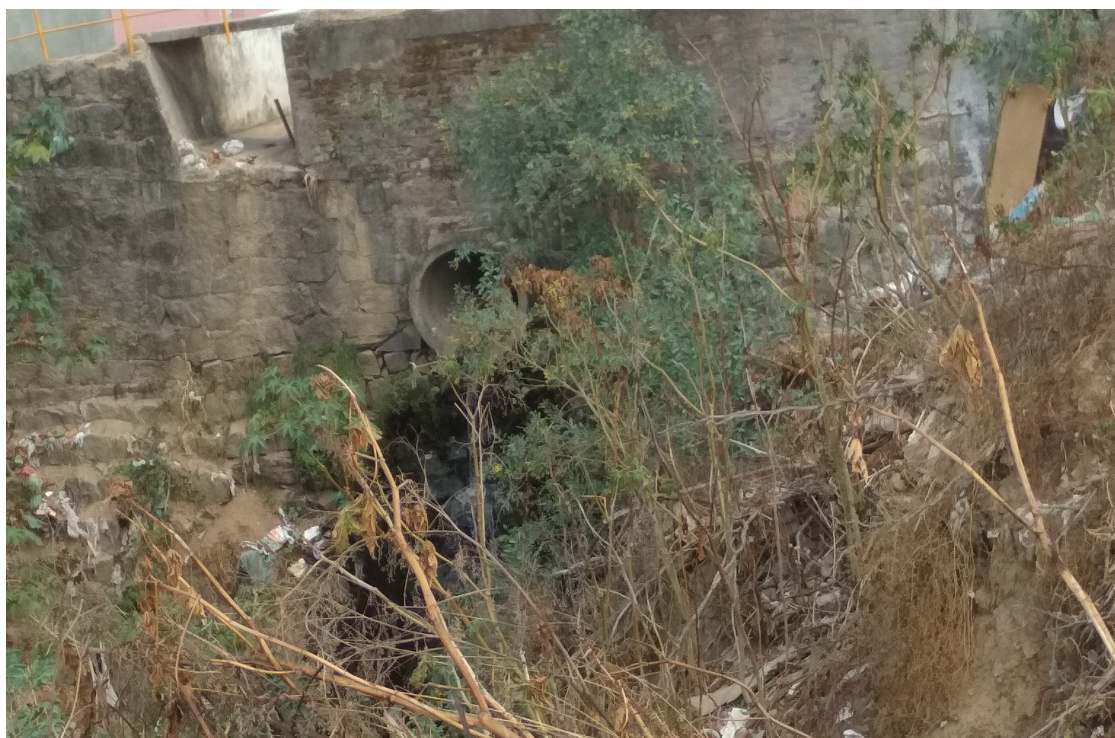
Figura 29: Área de Rede de Esgoto na Voçoroca da Liberdade.
